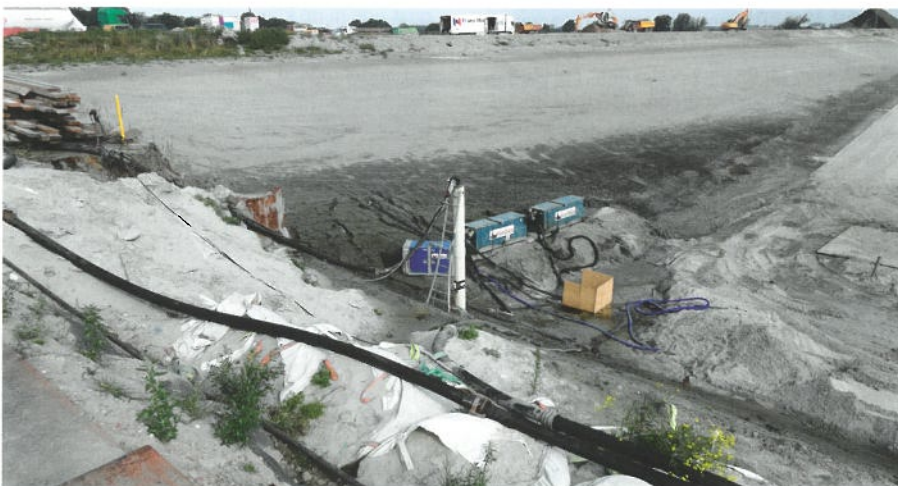
Diepwell-bemaling bij diepe polder voor infrastructuur.
